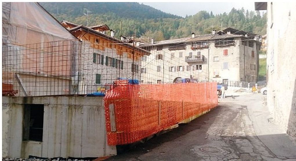
Il cantiere in piazza Pleù a Tione bloccato dalla guerra di carte bollate tra Cobumax e Consolini e il Comune
