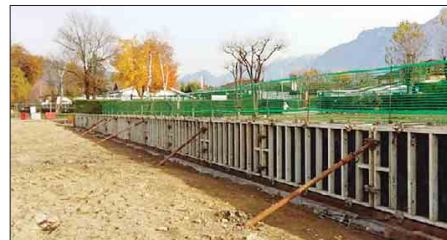
La stessa riva dopo i lavori: cemento e (in futuro) un cancello in putrelle
