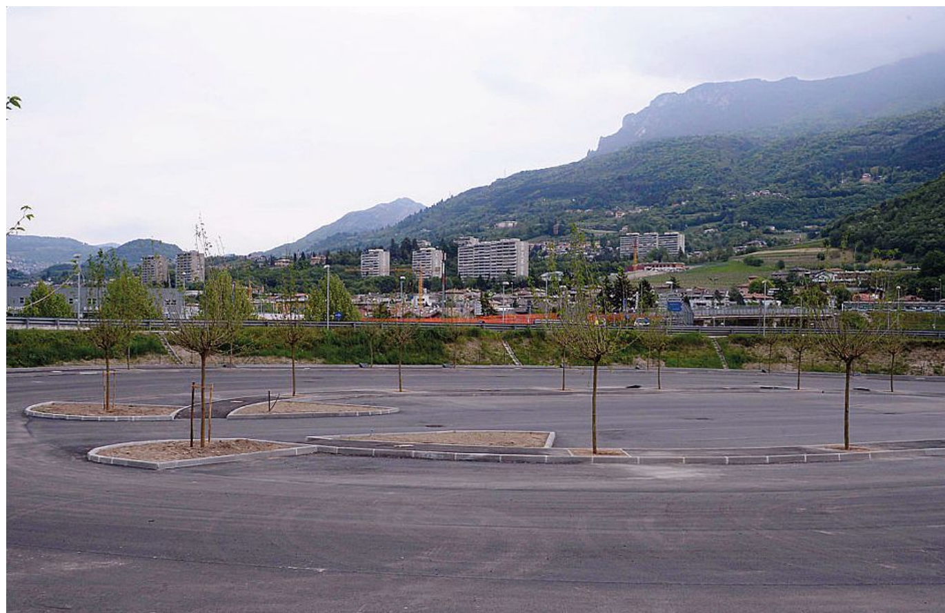
Uno dei due parcheggi a raso, quello verso l'aeroporto, già asfaltato. Nel secondo, vicino al Marinaio, fervono i lavori (fotoservizio Panato)
