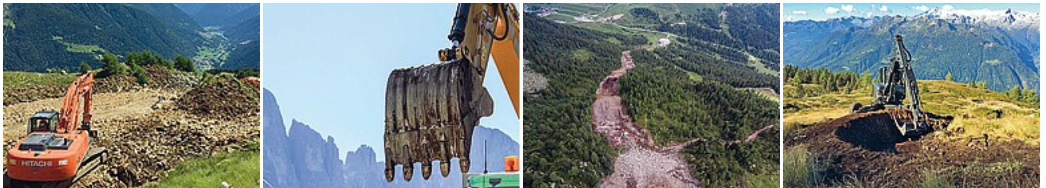
Nel mirino Da sinistra i lavori di realizzazione delle nuove piste a Pejo, ruspe in azione a San Martino di Castrozza, il nuovo tracciato in costruzione a passo San Pellegrino e la nuova pista da downhill a Pinzolo
