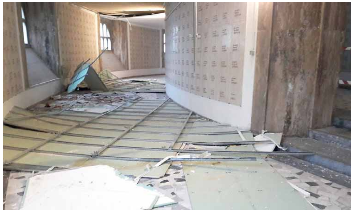
■ La situazione all'interno dell'Ossario con i controsoffitti crollati e le infiltrazioni d'acqua
