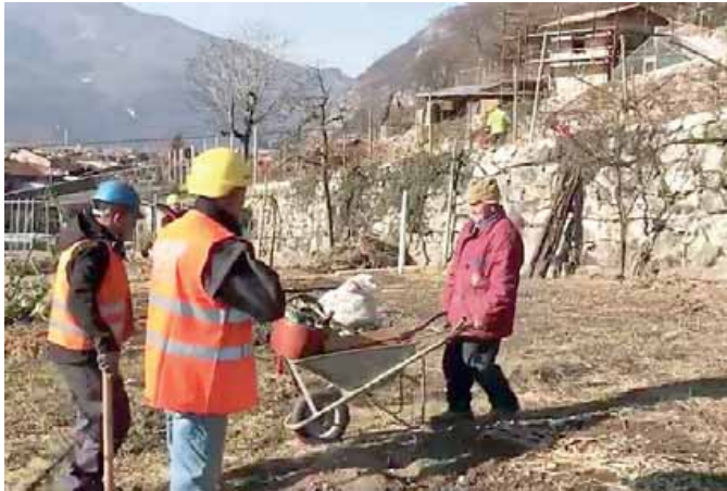
I vecchi muri a secco, demoliti in parte per la demolizione del diedro
