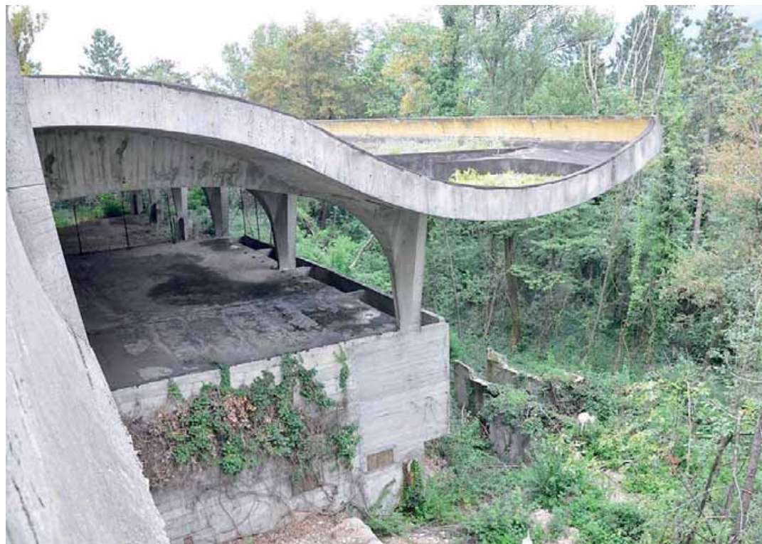
• Le "vele", la porzione più affascinante ed interessante di quello che comunque rimane un rudere pericoloso
