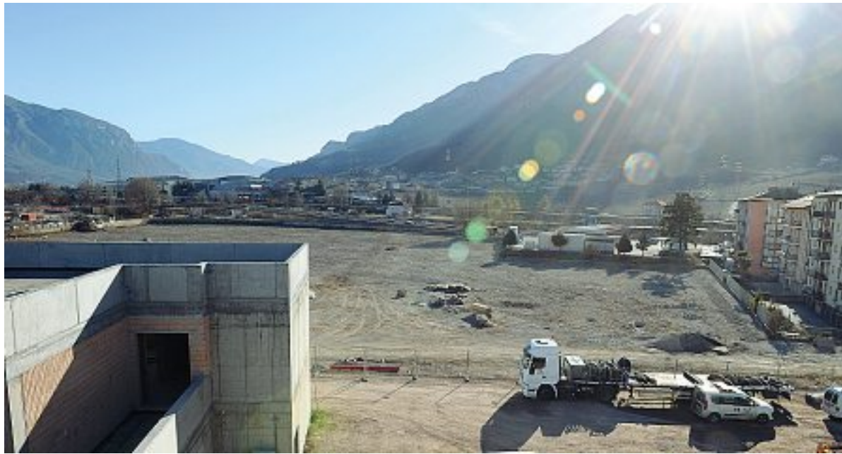
Via al Desert Il cantiere del nuovo ospedale che sorgerà a Trento sud. I tempi per la realizzazione dell'opera si allungano ulteriormente (Foto Rensi)
