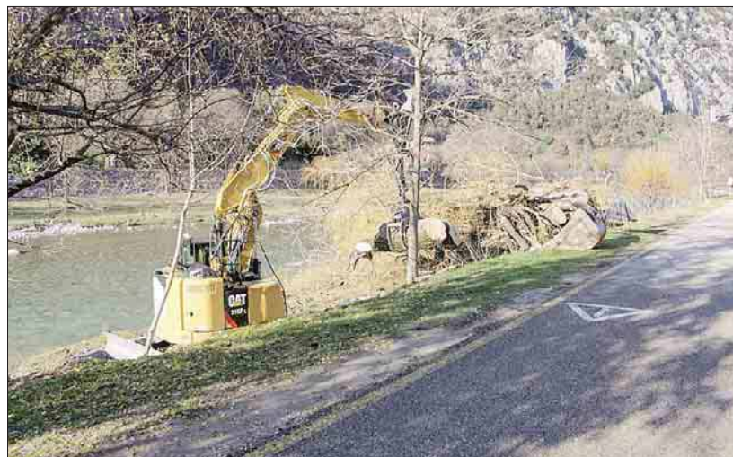
I lavori in corso lungo le sponde del fiume Sarca in questi giorni tra Arco e Dro
