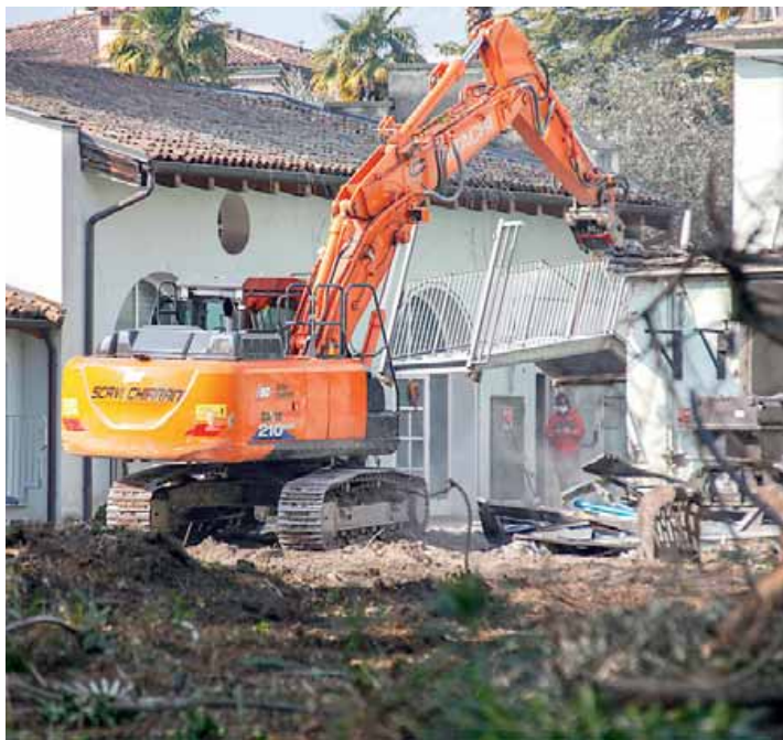
I lavori di demolizione avviati a «Villa San Pietro» giovedì scorso (Salvi)
