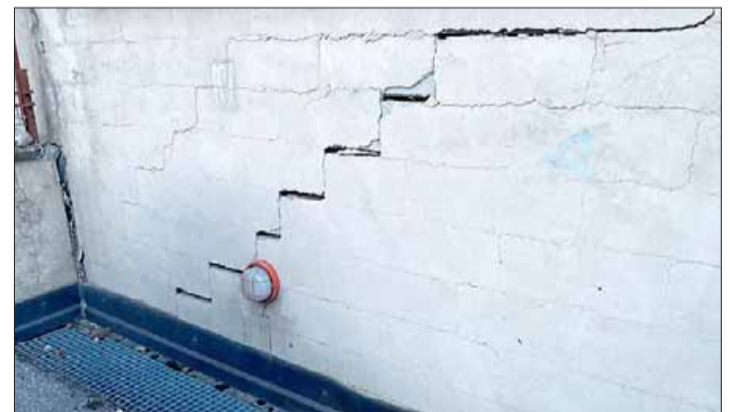
Le crepe sui muri causate dalla posa di barriere antirumore in Corso Buonarroti
