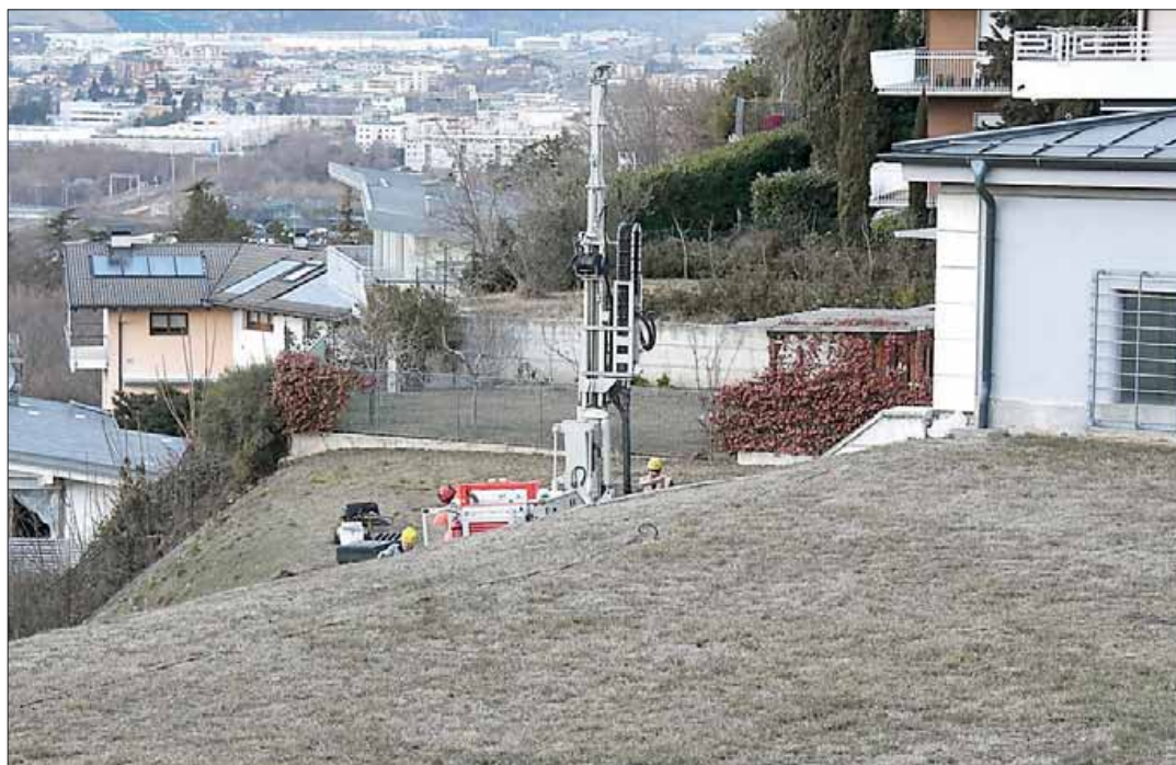
La trivella installata nella tarda mattinata di ieri tra via Spalliera e via Missioni Africane
