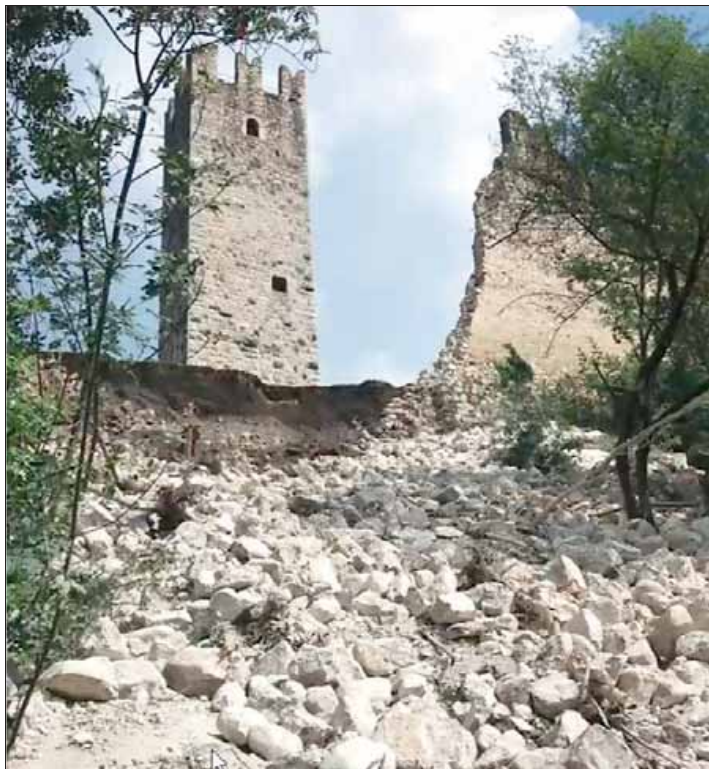
La cinta muraria di Castel Drena crollata nel giugno del 2018
