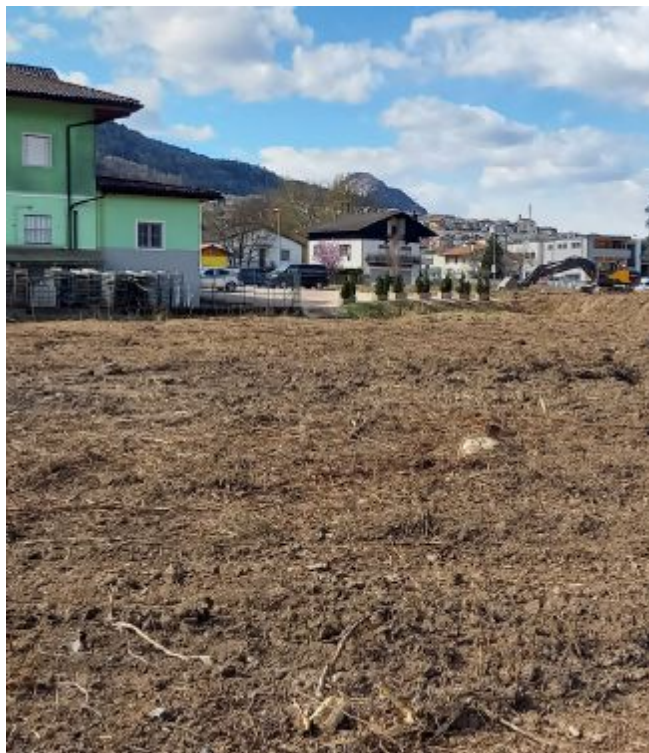
L'area Il lotto principale dopo il taglio di tutta la vegetazione presente
