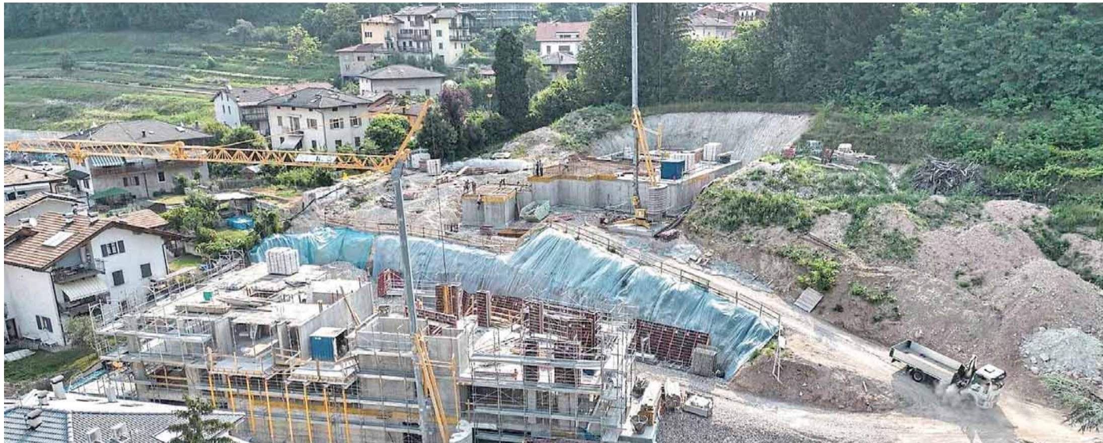
Un'immagine panoramica del nuovo complesso edilizio che si sta realizzando in una strada laterale di via Villa, nel cuore dell'abitato di Villazzano. Il caso è destinato a finire davanti al Consiglio di Stato. Intanto i lavori procedono
