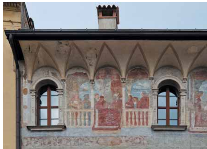
Un particolare della facciata che necessita un restauro
