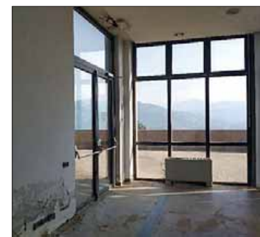
Gli spazi interni e la terrazza ammalorati
