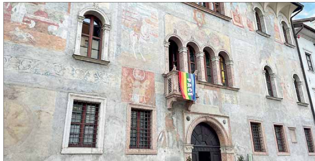
La facciata di palazzo Geremia, restaurata negli anni Novanta, ha già bisogno di un nuovo intervento
