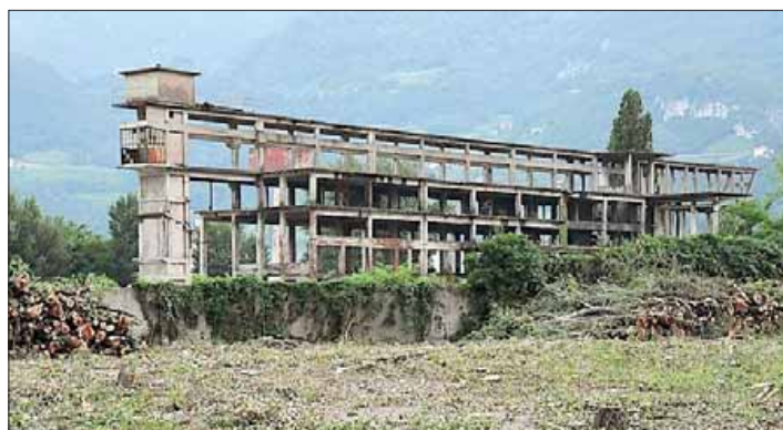
Il relitto ex Sloi. A destra la zona della barriera idraulica dell'ex Carbochimica
