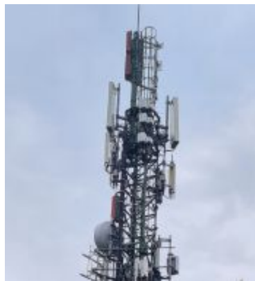
Struttura Un'antenna in zona
