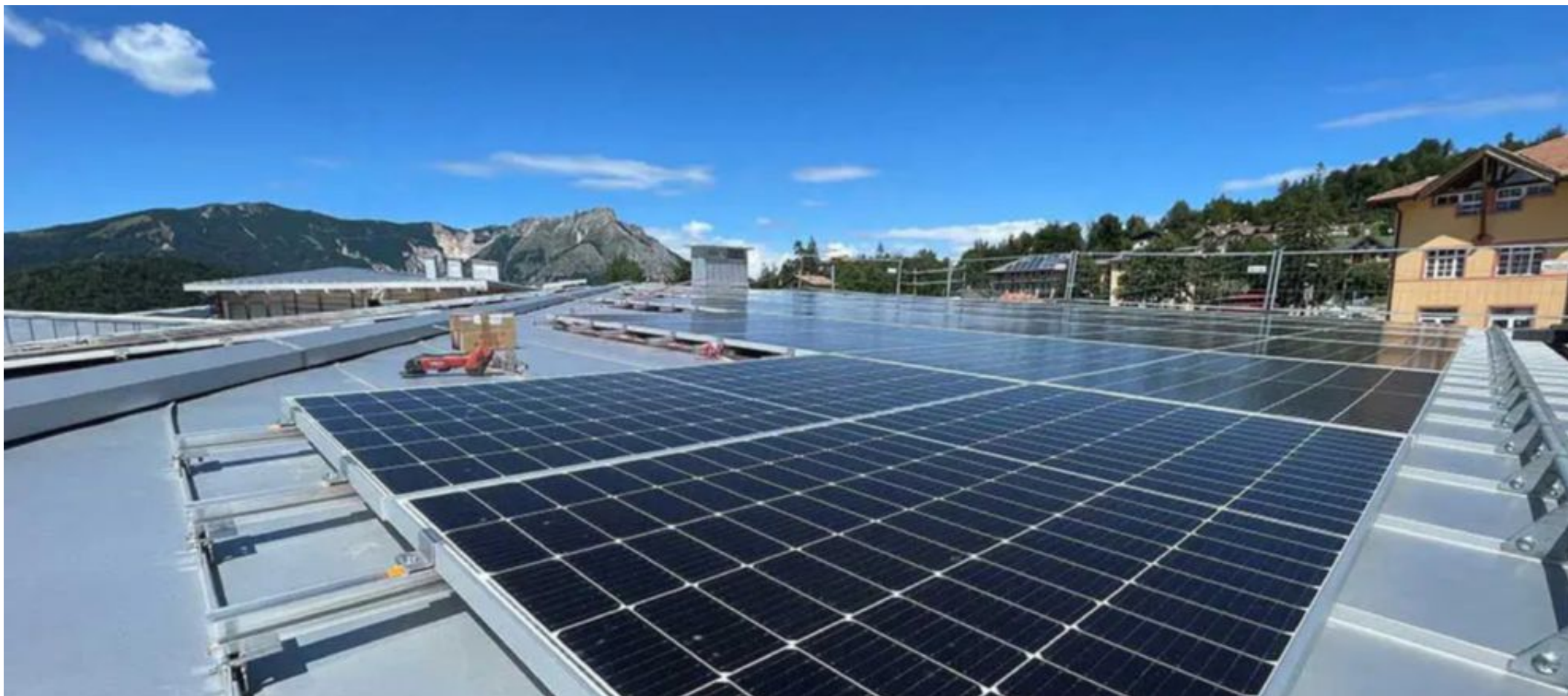
Pannelli Un impianto fotovoltaico installato su una copertura civile
