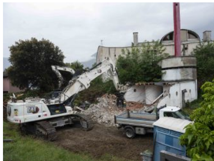
Edificio La ruspa in azione per demolire l'edificio «L'Arca» © Foto di Paolo Ghisu
