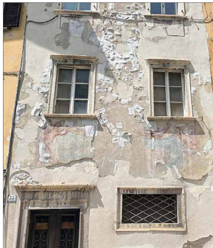
Le pessime condizioni della facciata dell'ex Osteria della Croce Bianca
